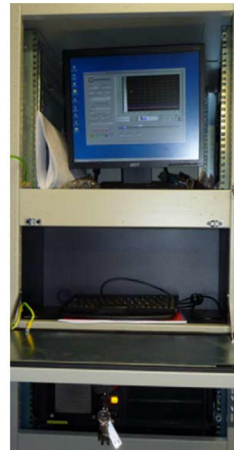
Baie d'acquisition des données de températures DTS (Distributed Temperature Sensor)
