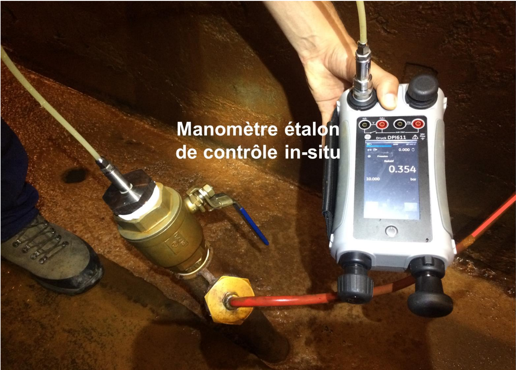
Photo de contrôle d'un piézomètre
